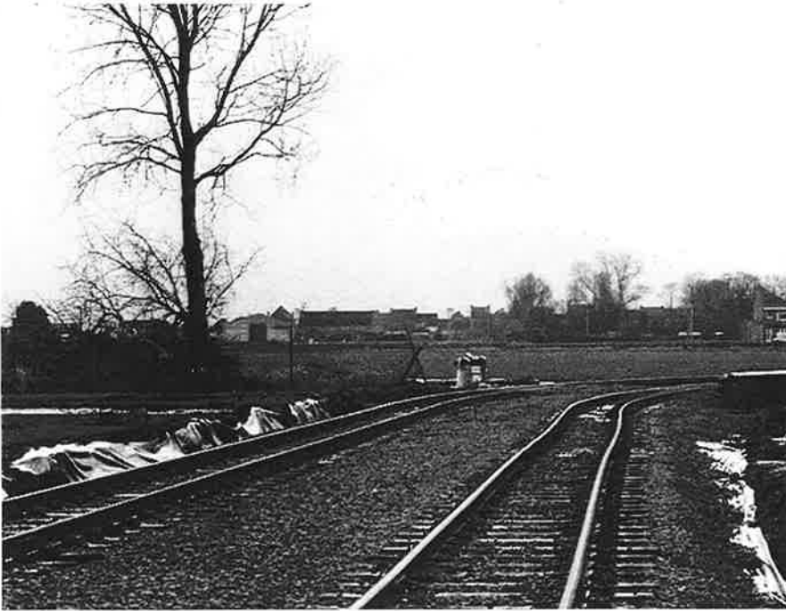
Deze foto toont de aanleg van de sporen achter de huizen van de De Pannelaan en de reserveparking van het Melipark. De sporen draaien naar rechts, om een vijftigtal meter verder de baan De Panne - Adinkerke te kruisen. De foto is genomen in de richting van Adinkerke, op 12 december 1997. Foto : Stefan Justens
